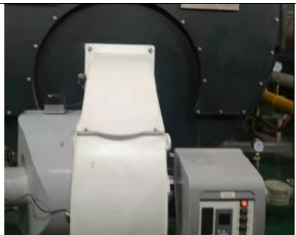
低氮燃烧装置
